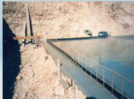
In den Frischbeton nachträglich eingedrückt
